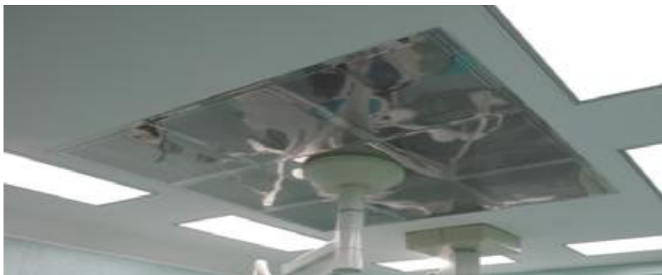
Fig.no.7.3 laminar air diffuser
